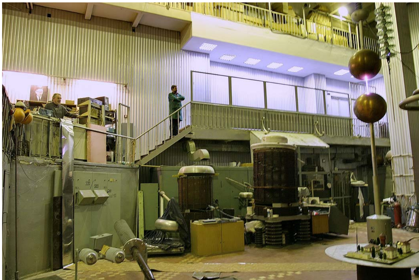
Высоковольтный зал МЭИ
