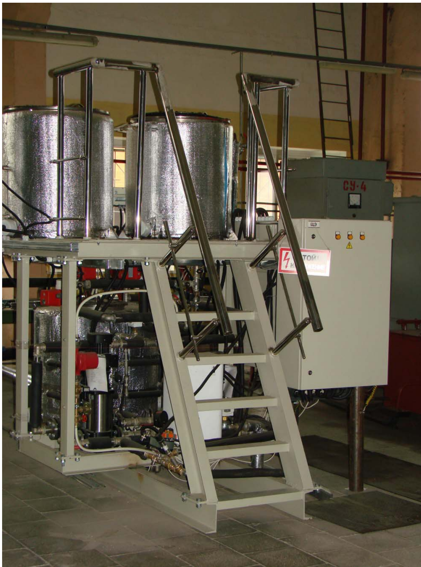
Стационарная автоматизированная установка для реализации ПАВ-технологии в системах теплоснабжения
