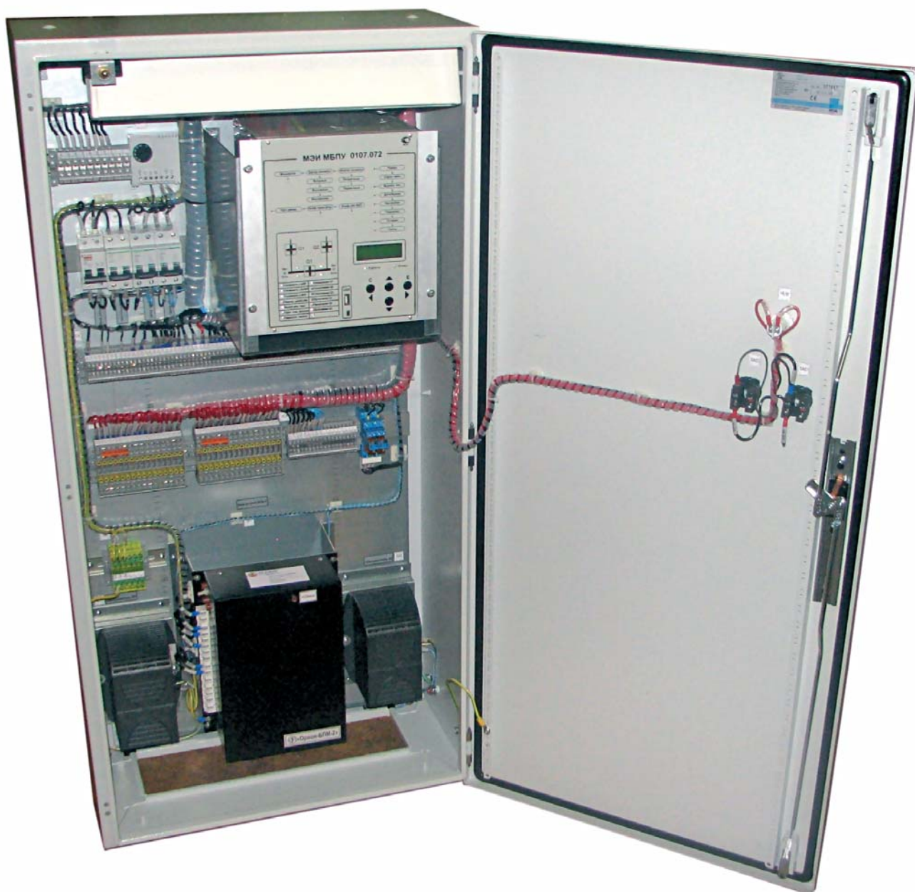
Шкаф управления устройства быстродействующего автоматического включения резервного питания (БАВР) разработки кафедры ЭПП
