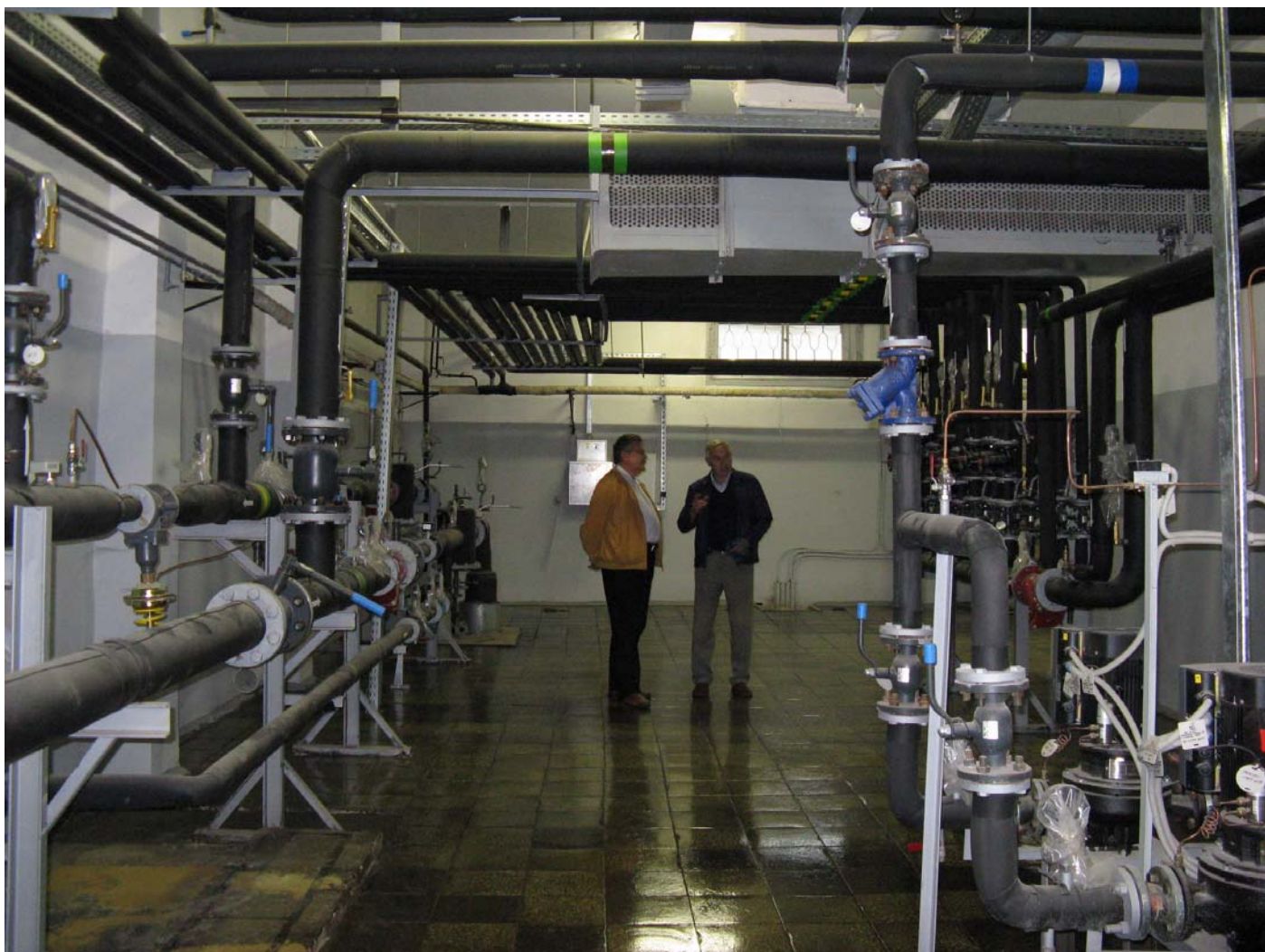
Центральный тепловой пункт
