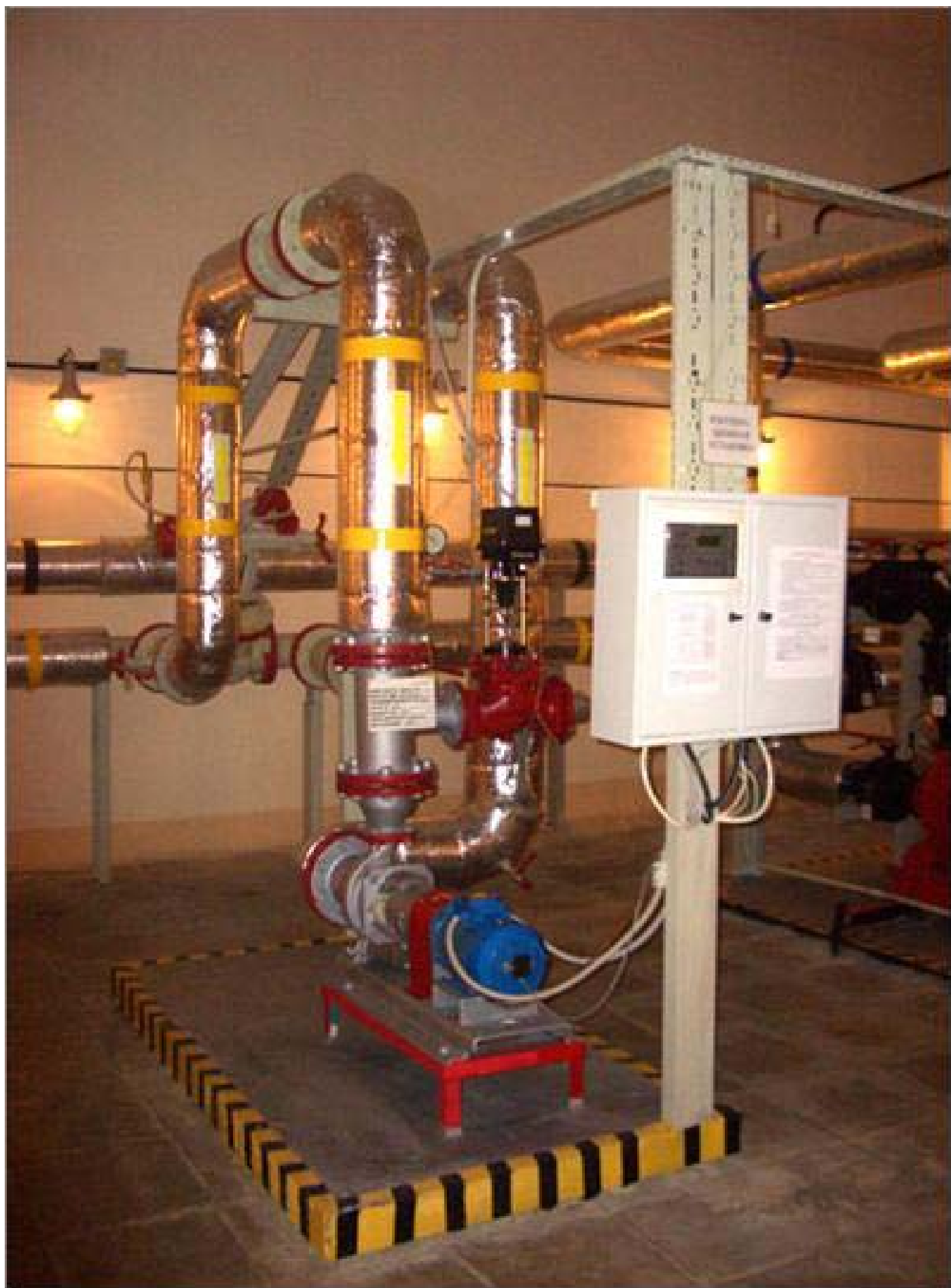
Установка для преобразования избыточного давления в системах тепло и водоснабжения
