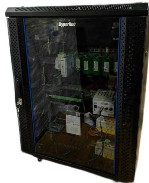
Система мониторинга показателей токопроводов
