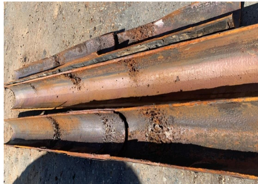
Пример практически не обнаруживаемых участков питтинговой коррозии внутренней поверхности труб
