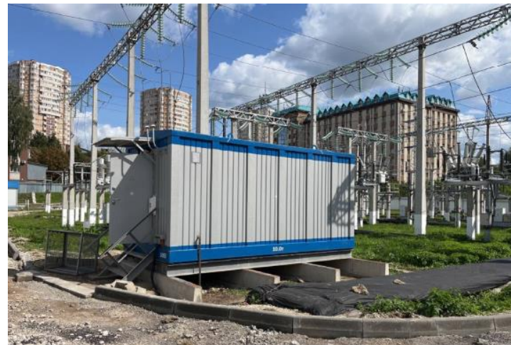
Опытная эксплуатация ИСРЗА на объекте ПС 110/10 кв «Мамулино»
