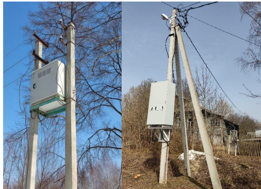
Опытно-промышленная эксплуатация полупроводниковых устройств стабилизации переменного напряжения (объект Ярэнерго, объект МОЭСК)
