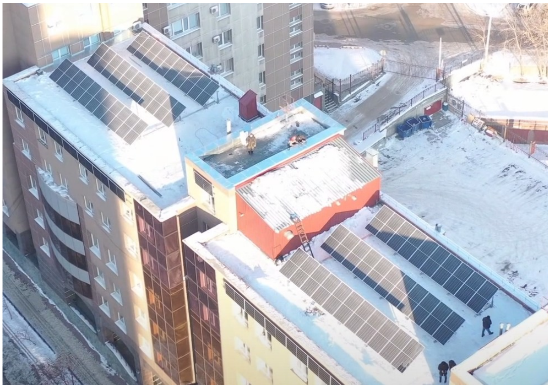
Рисунок 29 – Солнечная электростанция. Новосибирскэнерго, город Новосибирск
