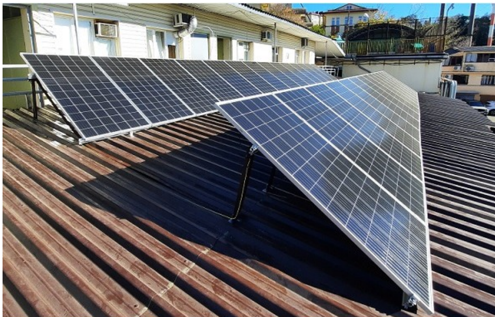
Рисунок 27 – Солнечная электростанция. Санаторий «Заполярье», город Сочи
