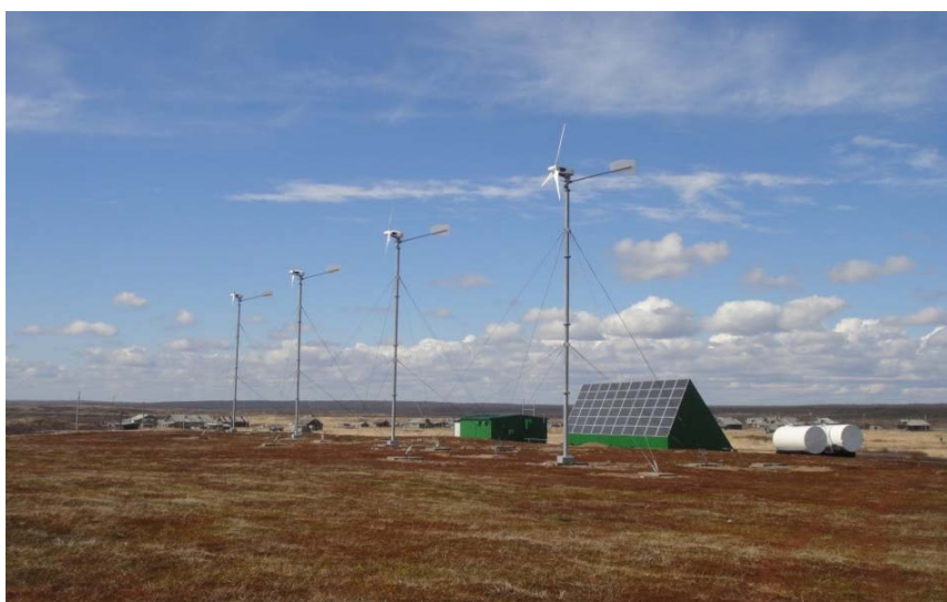
Рис. 5. Гибридная энергоустановка с использованием ВИЭ в селе Пялица
