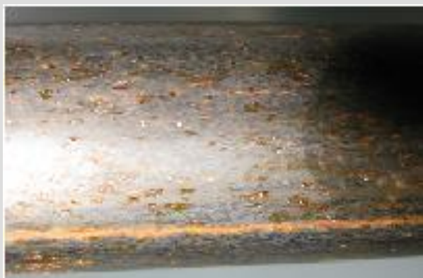
ФОТОГРАФИЯ ТРУБОПРОВОДА ХОЛОДНОГО ВОДОСНАБЖЕНИЯ ТЕПЛООВОГО ПУНКТА УЧЕБНОГО КОРПУСА НИУ МЭИ
