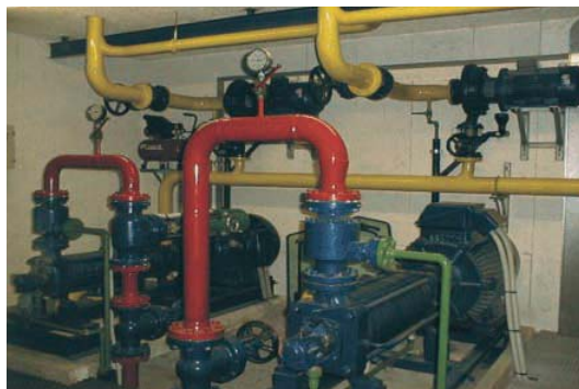
↑ Рис. 31 Насосная станция водоподготовки
