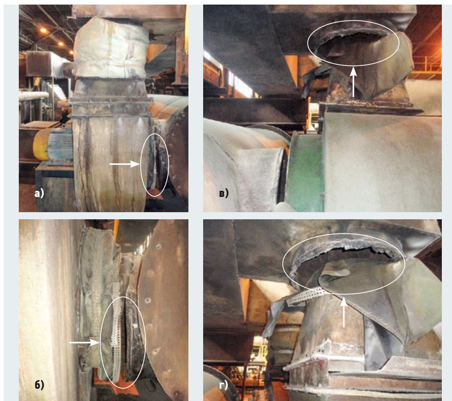
❖ ФОТО 2. Дефекты мест подсоединения воздуховодов вытяжной системы к радиальному вентилятору (а и б; в и г) на производстве
