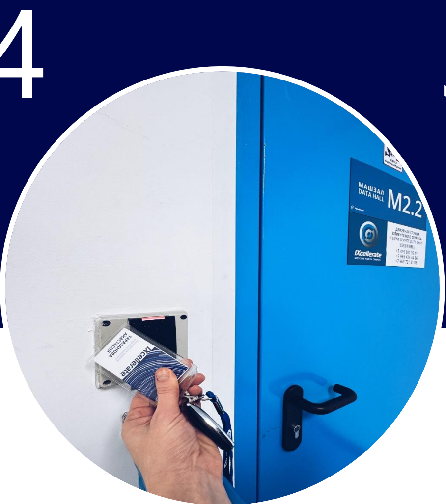
Вход в машинный зал
