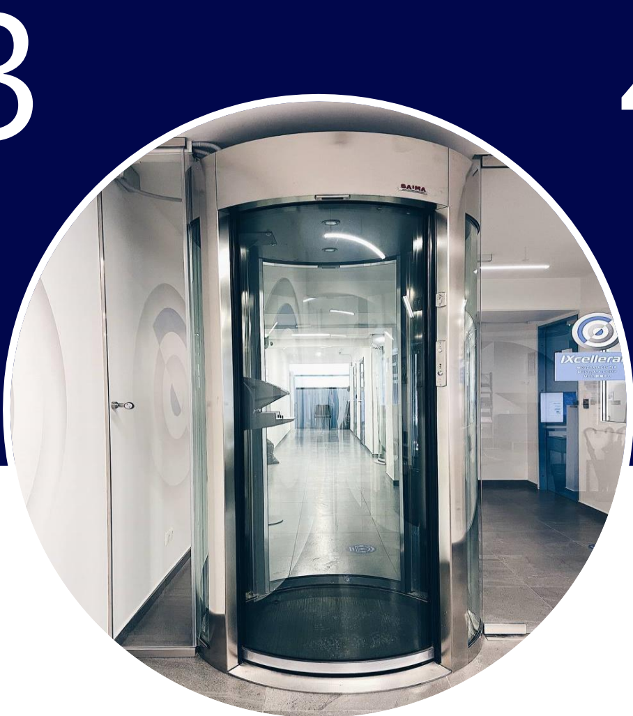
Вход в зону ЦОД
