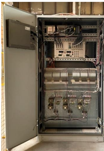
Рис. 10. Шкаф системы управления ФПУ
