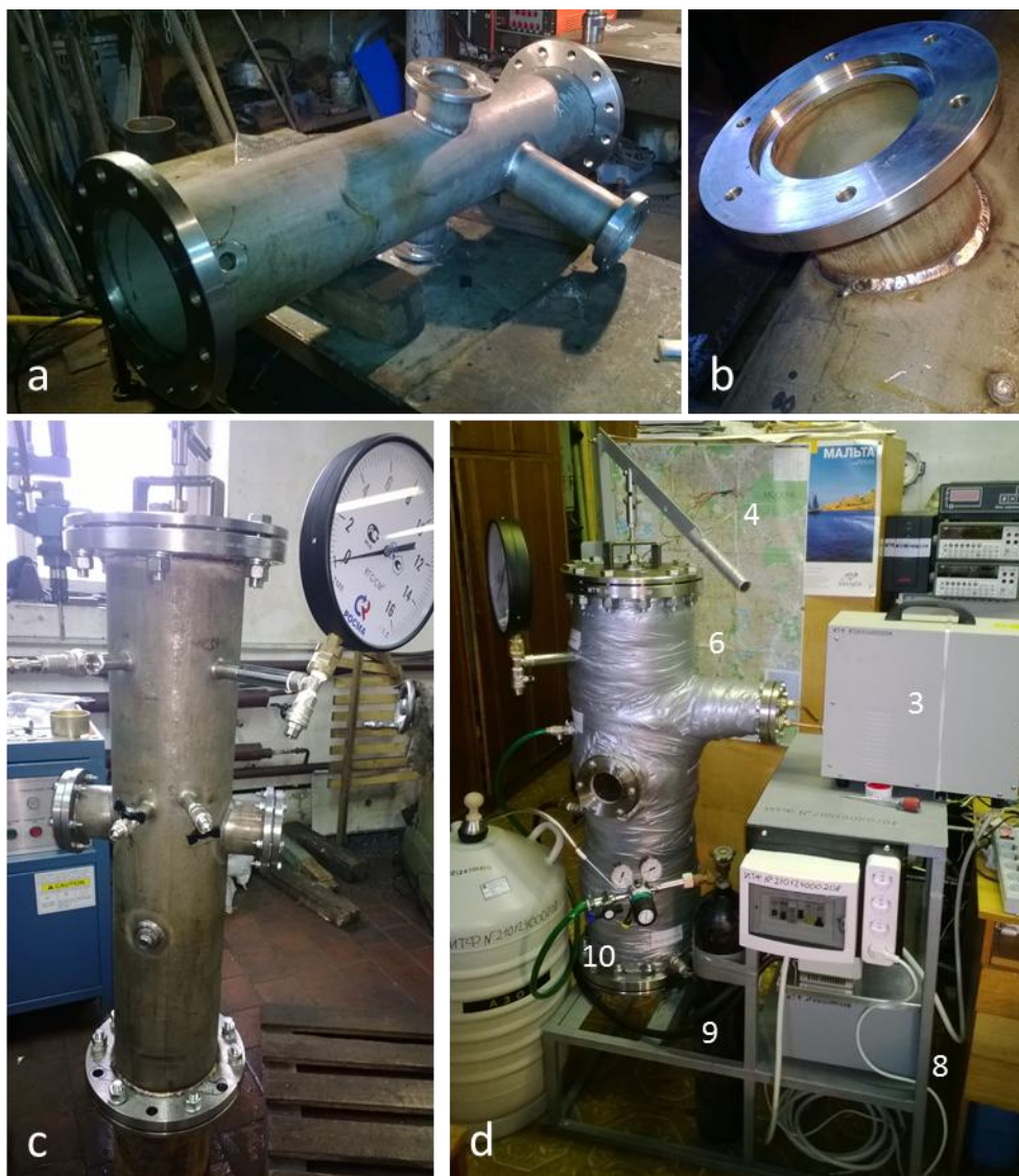
Рис.2.1. Фотографии экспериментального стенда: а) сварочные работы, б) пример сварного шва, с) опрессовка установки, д) готовая экспериментальная установка.
