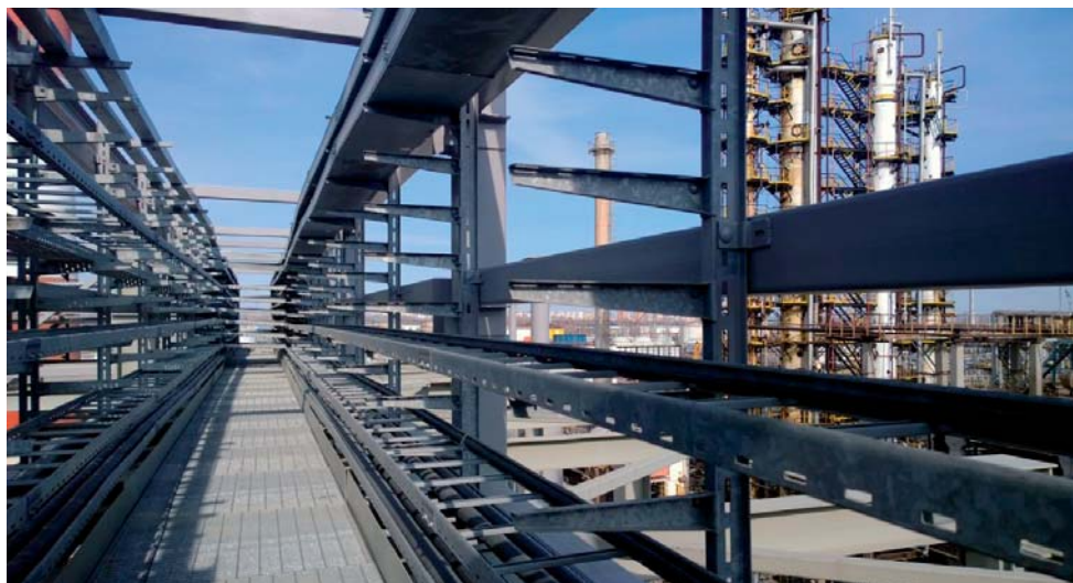
Кабеленесущие системы ОБО Беттерманн на заводе по производству полипропилена в Тобольске — «Тобольск-Полимер» (Тюменская область)
